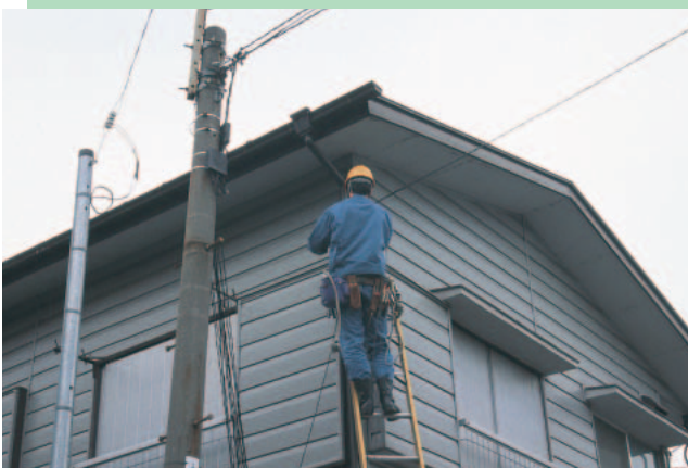
今回工事を行ったアパート。2階の部屋まで光ファイバーを引き込む工事は、約1時間半で完了した。
