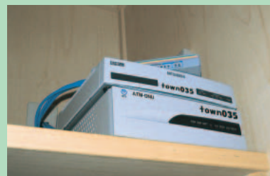
押し入れの中には、光ファイバーからイーサネットへ変換するための装置が。下からONU、NA、ハブ。
