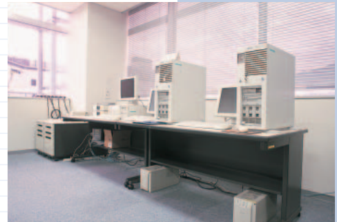
ドコモ中国が所有するモバイルセンター内にあるサーバーーム。
