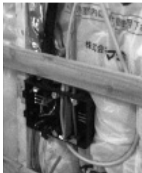
LAN, ISDN, TV, CATVと電源。このセットが9カ所に付く。
