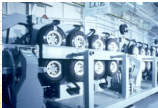
タンクから海へとケーブルを送り出す「リニアケーブルエンジン」。ケーブルや中継増幅機を傷めないよう、ゴムタイヤがケーブルをはさむ。
