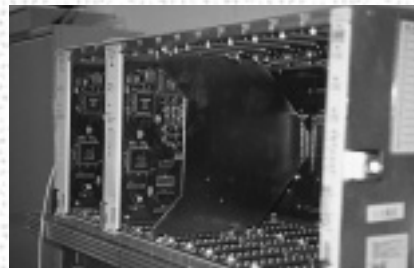
有線放送のセンターに設置されている集合型ADSLモデム
