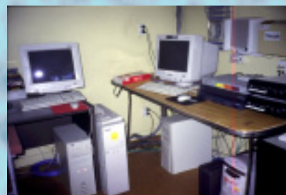
サーバーやルーターが並ぶコントロールセンターの一角。
